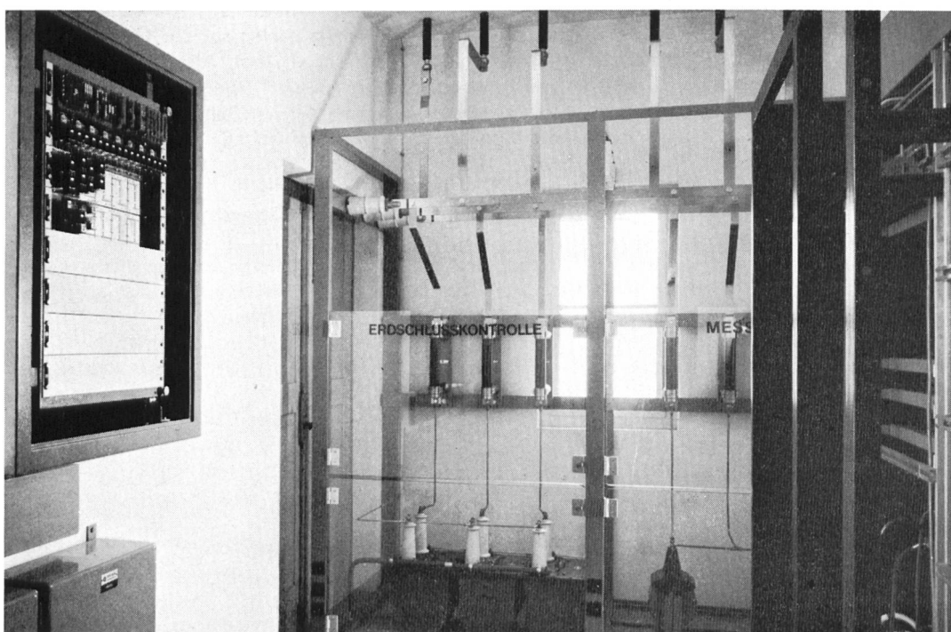
Bild 4 Teilansicht der SAK Einspeise- station «Nutenwil»
