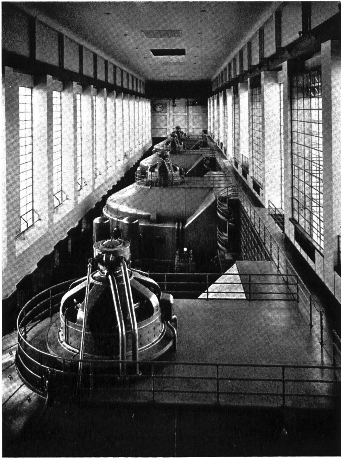
Kraftwerk Ryburg-Schwörstadt AG, Rheinfelden (Schweiz)
