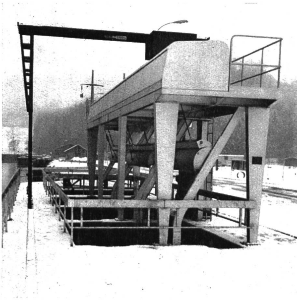
Kühlwasserfassungen der Atomkraftwerke Beznau I + II Je 3 Rechen und automatische, stationäre Rechen-Reinigungsmaschinen
