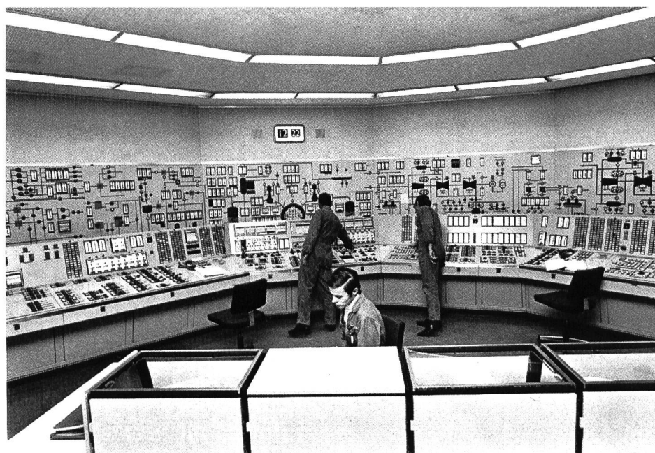
Bild 1 Der Kommandoraum des Atomkraftwerkes Beznau-Döttingen der NOK. Von diesem Zentrum aus wird das ganze Kraftwerk überwacht und gesteuert. An der Wand die Rückmeldetafel mit Messinstrumenten zur Anzeige von Messwerten aus allen Teilen der Anlage, davor das Steuerpult und ganz im Vordergrund die Ausgabeschreibmaschinen eines Computers, der zusätzlich zur Anlageüberwachung dient.
