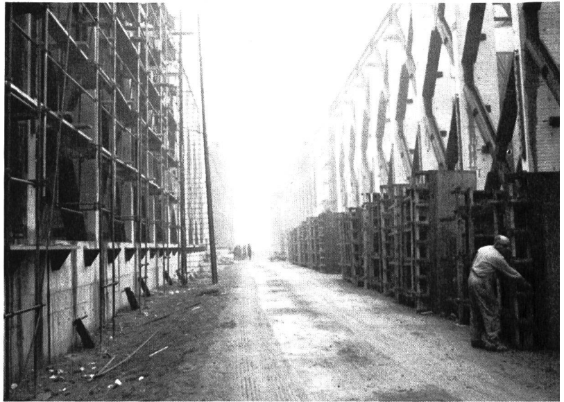
Bilder 25 (links) und 26 (oben) In einer Bodensenke werden die riesigen Senkkasten an Land erstellt — sie erinnern an eine im Entstehen begriffene moderne Stadt — um nach Fertigstellung geflutet und mit Schiffen kilometerweit zur Einbaustelle für den Abschluss des Brouwershavensche Gat gefahren zu werden
