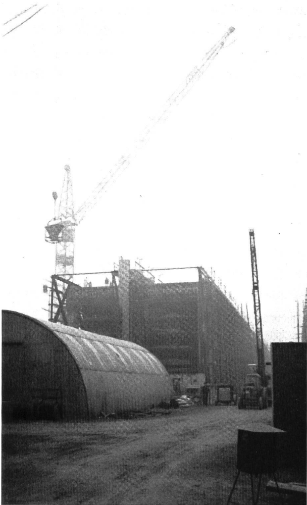
Bild 27 (unten) Konstruktion für das Einbringen des Abschlussdammes im östlichen Teil des Haringvliet
