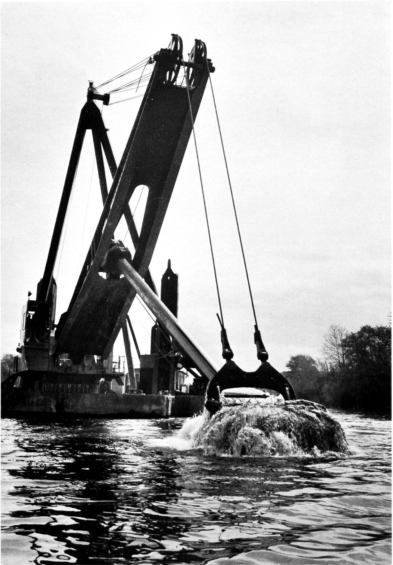
Bild 1 Mit dem Einsatz modernster, für Europa erstmaliger Installationen wurde das Werk grosszügig angepackt: Der Manitowoc-Schwimmbagger.
