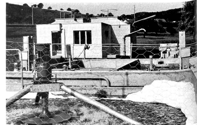
Bild 4 Oberflächenbelüftung in der Kläranlage Tegerfelden (Blockbauweise).
