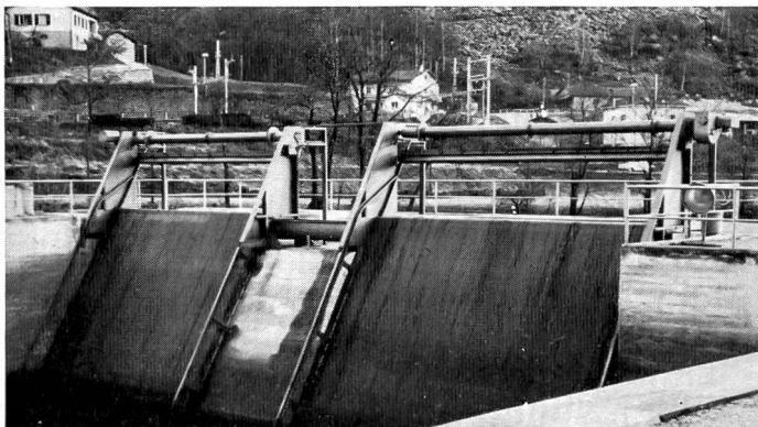
Rechenreinigungsanlage Biaschina der AET
