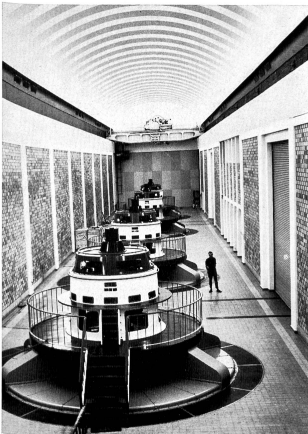
Bild 9 Inneres der Zentrale Tokke I, vier Einheiten zu 100 MW für 377 m Gefälle, 375 U/min.
