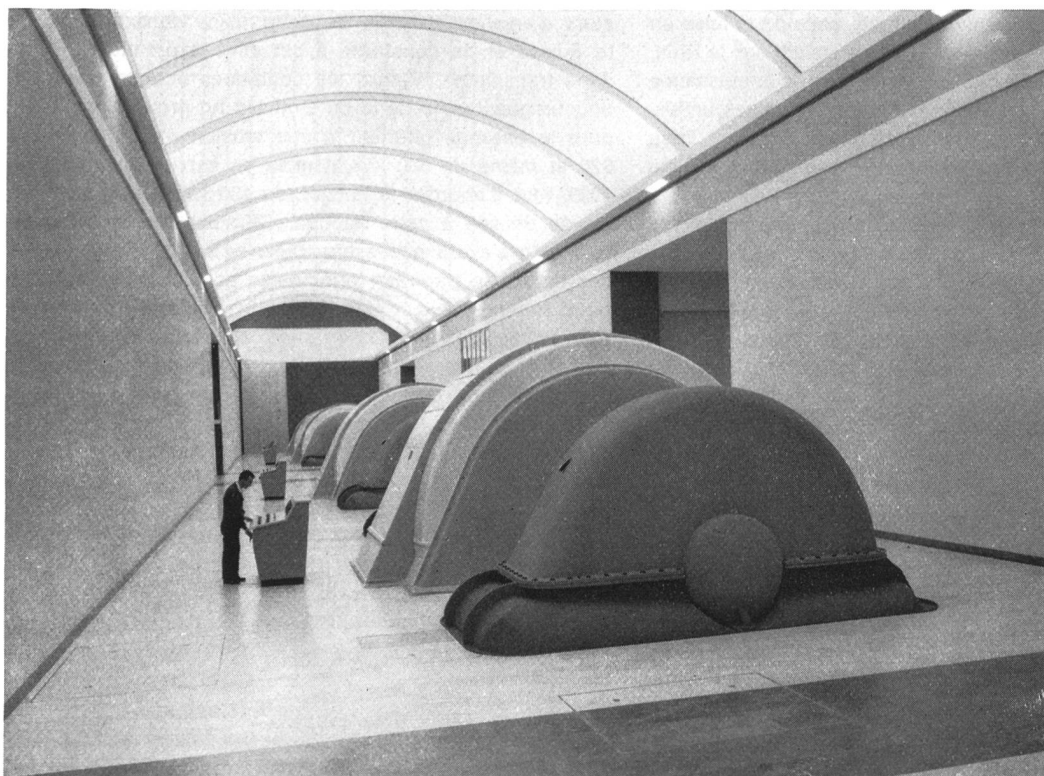
Fig. 14 Kavernenzentrale Biasca der Blenio-Kraftwerke AG (Tessin) erbaut 1956/1960
