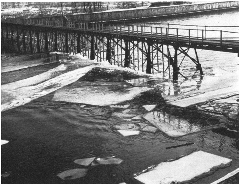
Fig. 9 Kraftwerk Rheinfelden: Platteneis am Grobrechen des Kanaleinlaufes, 10. 2. 1963 --
