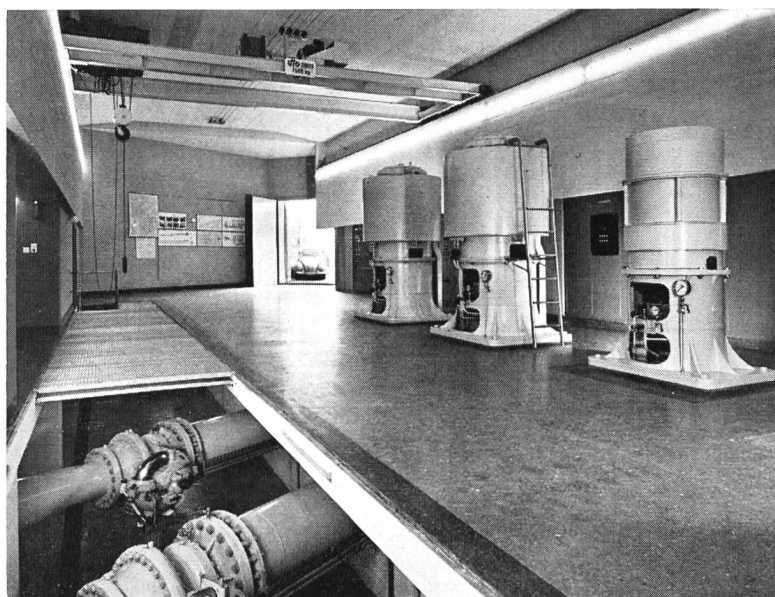
Bild 3 Seewasserwerk II, Pumpwerk Tiefenbrunnen; Innenaufnahme
