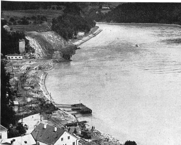
Bild 24 Das Schwallleck nach Sprengung des Felswalls
