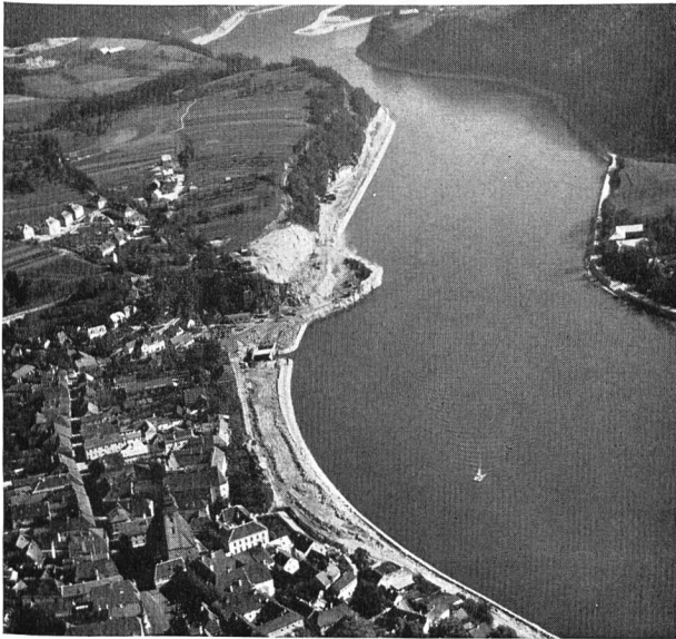
Bild 23 Bild des abgesprengten Schwallecks mit Felswall
