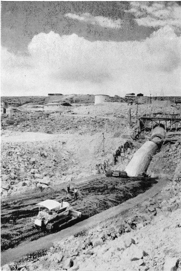
Bild 109 Dammbauarbeiten am Flusse Cetina für die Kraftwerkgruppe Split in Kroatien; der 63 m hohe Erddamm mit 770 000 m 3 Materialvolumen schafft den Stausee Peruća von 520 Mio m 3 (Nutzinhalt 495 Mio m 3 ).
