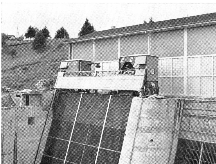
Zwei elektrisch und mechanisch gekuppelte Maschinen während dem Versetzen der Dammbalken vor dem Rechen.
