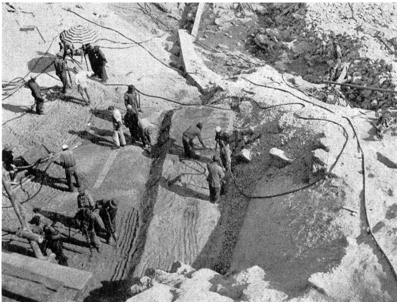
Abb. 10 Erddamm Marinel, Belgisch-Kongo. Verdichten des Filter- und Kernmaterials im Kontakt mit Fels. (Photo Ch. Schaerer)
