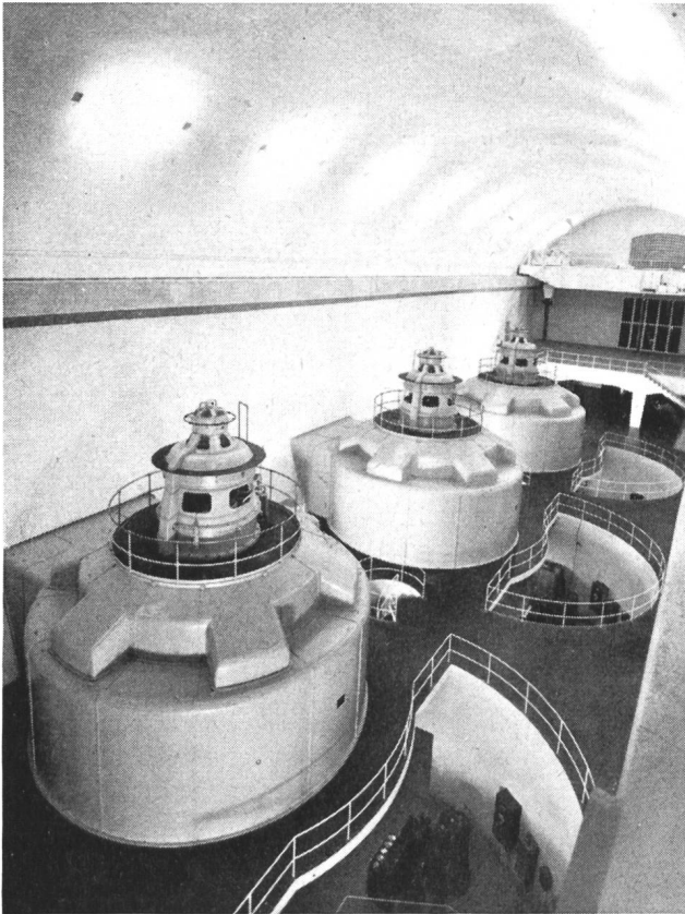
Abb. 20 Inneres der Kavernenzentrale Taio / S. Giustina (Photo S. E. M. / Soc. Edison)
