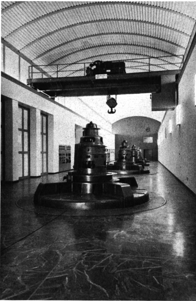
Abb. 3 Inneres der Zentrale Verbano mit vier Maschineneinheiten. Durch den schöngezeichneten grünen Marmorboden und die orangefarbenen Stirnwände wirkt der Kavernenraum sehr ansprechend.
