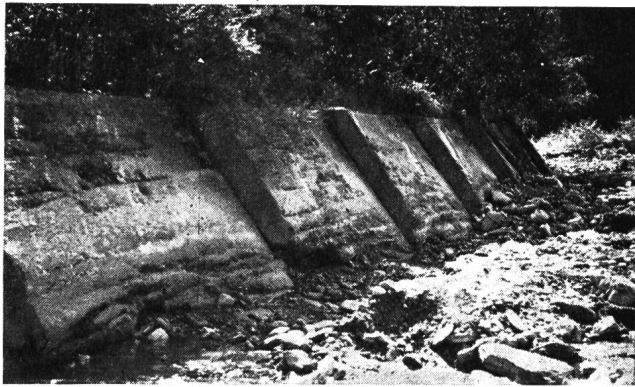
Abb. 8 Nollatobel. Verkleidung der Flügeldämme einer modernen Quersperre mit dachziegelartig übereinanderliegenden Betonplatten, die dem Bergdruck ohne Schaden nachgeben können, von der Bacherosion aber sehr rasch zernagt werden. Zustand am 4. 9. 1951
