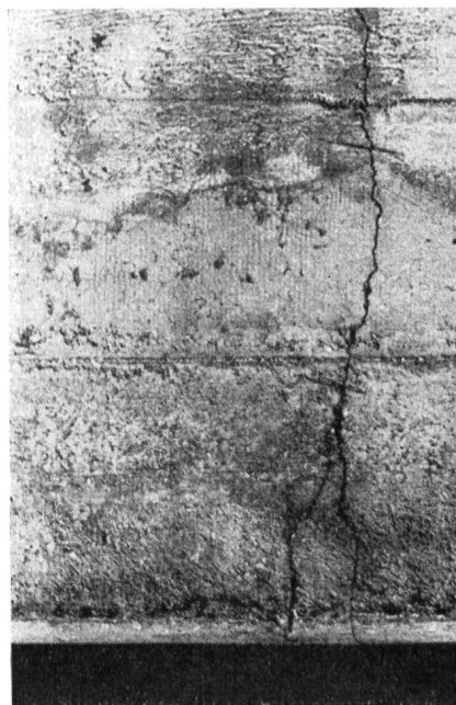
Abb. 33 Risse in der Brüstung der Salgina-Brücke. Die Brüstung ist als Ganzes schon um 2–3 cm verschoben. Photo R. U. Winterhalter.
