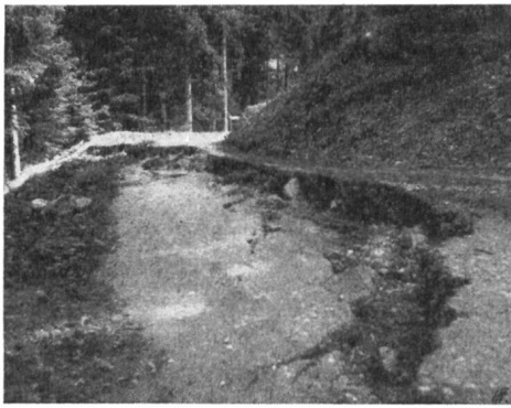
Abb. 16 Strassen-Abrutschung im Frühjahr 1945 beim unteren Drosbachtobel, als Folge von verlaufendem Quell- und Bachwasser am höheren Berghange. Zur Sicherung dieses Gebietes wurden am oberen Hang Quellen freigelegt, gefasst und abgeleitet.
