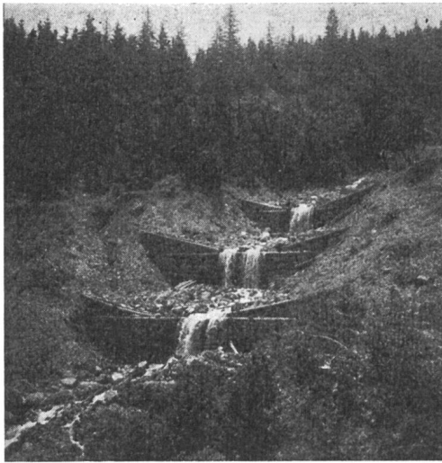
Abb. 5 Typisches Detailbild der Sperren am Casolf-Wildbach mit noch zu stark verwässerten, rutschenden Tobelhängen. Die Sperrbauten sind daher von Rutschmaterial schon stark überladen.
