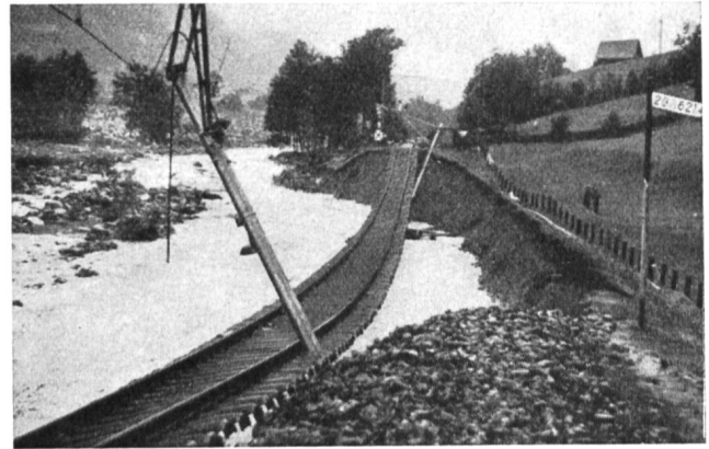
Abb. 10 Bahndamm SBB zwischen Rütli und Linthal nach dem Gewitter vom 2. September 1944 (gleiche Stelle wie Abb. 3).
