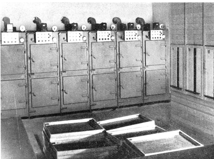
Fig. 19 Ofenanlage der Dörranlage des Elektrizitätswerks Burgdorf.
