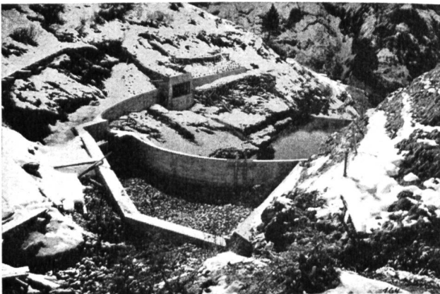
Abb. 4 Kraftwerk Tagenstal, Gesamtansicht der Fassungsanlage mit Ueberlauf, Blick in den provisorischen Weiher.
