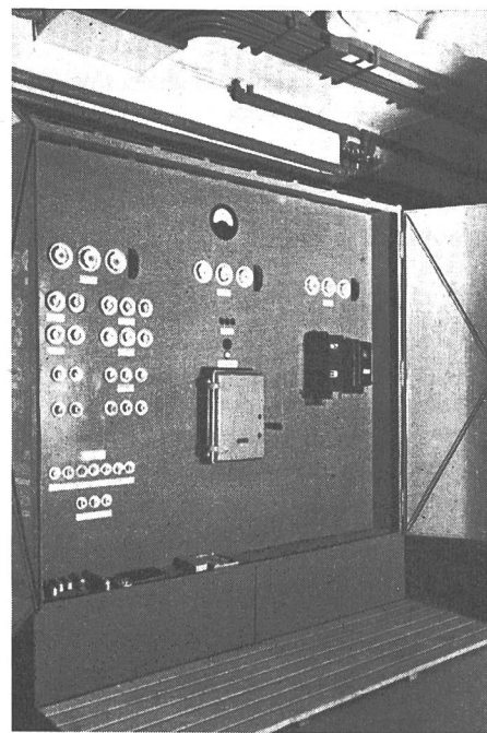
Fig. 42 Hauptverteiltabelleau, offen. Tableau principal de distribution, ouvert.
