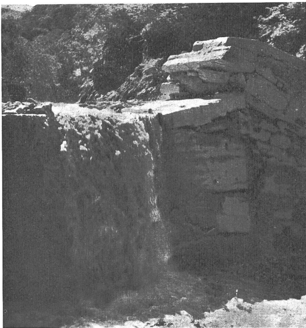
Abb. 4 Nollaverbauung. Sperre III unter Einwirkung des Bergdruckes. (Nr. 5045 BRB 3. X. 1939)
