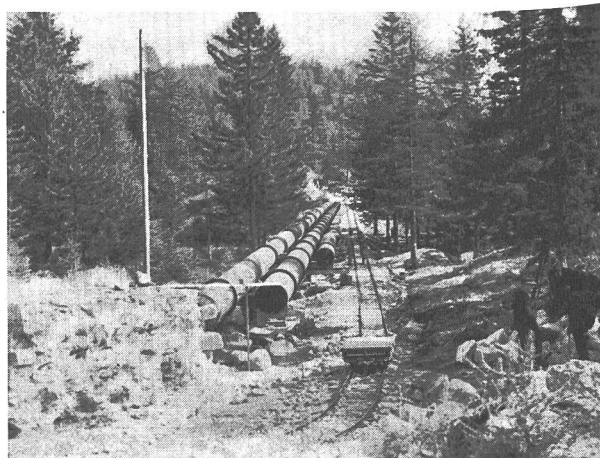
Abb. 3 Obere Partie der Druckleitung, Fixpunkte 2 und 3, August 1940.
