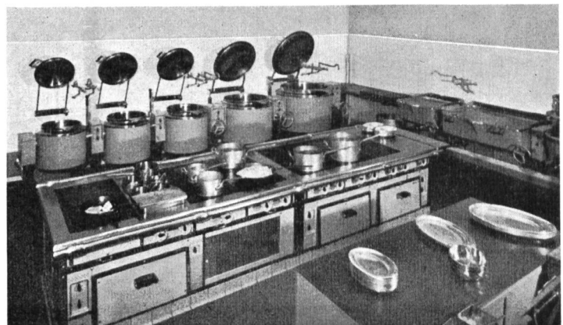
Fig. 21 Kochherd, Kippkessel- und Bratpfannengruppe. Cuisinière électrique, poste des marmites basculantes et les poêles à frire.
