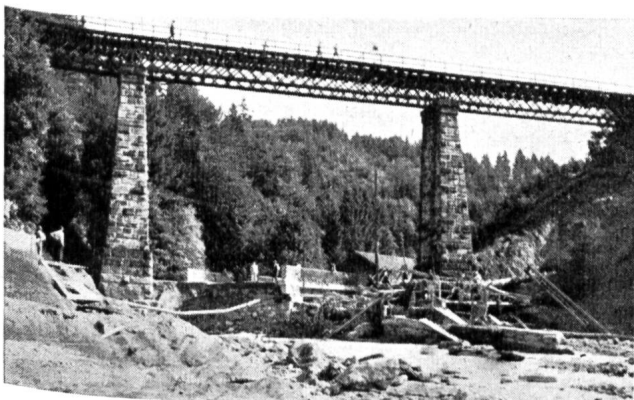
Abb. 6 Die Holzansammlung am Fallengestell eines Wehres (Grundtal) und deren Folgen.
