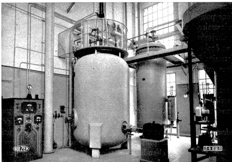
Fig. 70 Centrale thermique de Pierre de Plan. Chaudière électrique Sulzer de 5000 kW et son panneau de réglage; au fond un transformateur de chaleur.
