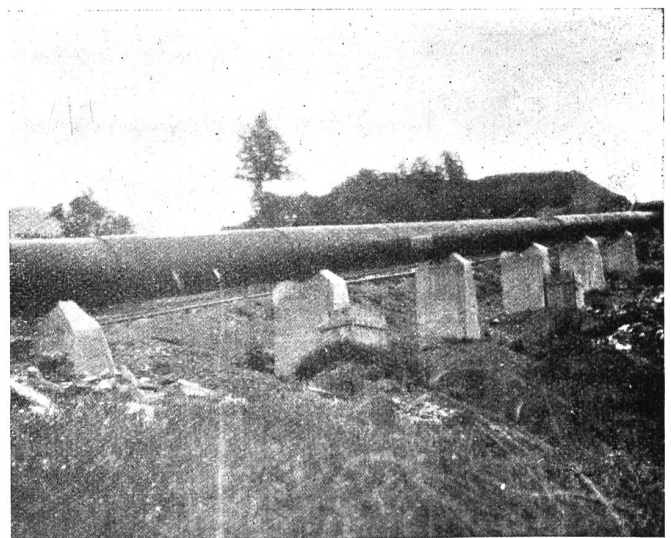
Abb. 11. Illsee-Turtmann. Druckleitung Oberems-Turtmann. Rohrpartie auf Sockeln.
