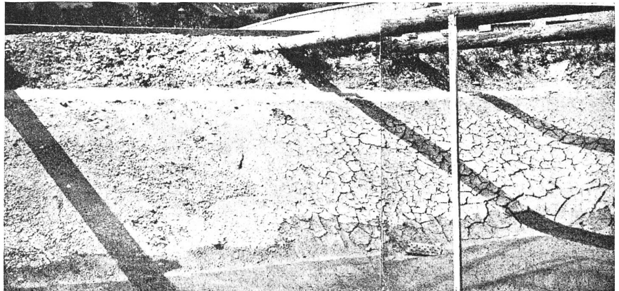
Abb. 4. Links: kompakter Lehmbeeton, rechts: gerissener Lehmbeleg auf einer Sandböschung im offenen Bassin.
