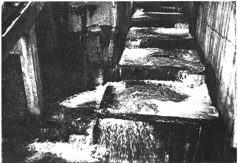
Abb. 30. Stauwehr des Elektrizitätswerks Kallnach. Teil der Fischtreppe, von oben gesehen.
