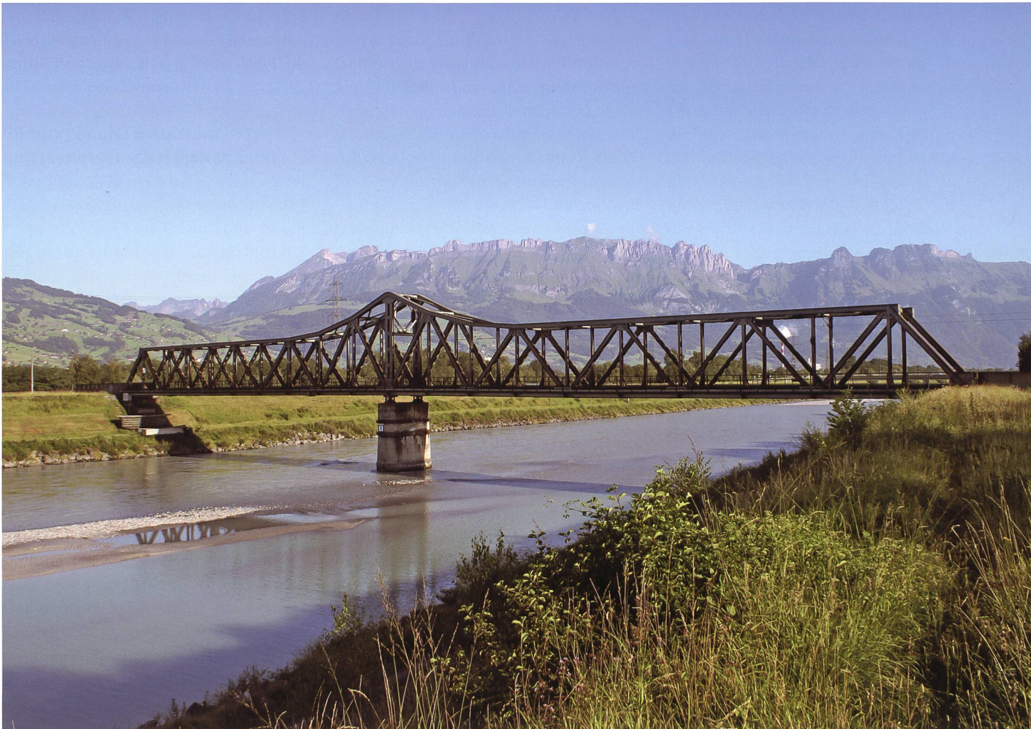
Die Rheinbrücke der ÖBB zwischen Buchs und Schaan. Foto Anton Heer, 17. Juli 2014
