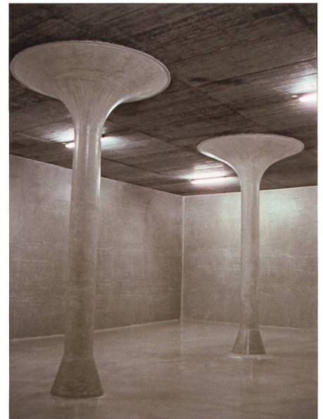
Eine der beiden je 900 Kubikmeter fassenden Kammern des Talzonenreservoirs Perdell (Ampadell) in leerem Zustand.
