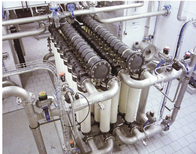
Zwei identische Ultrafiltrationsanlagen können auf Grist je bis 1000 Minutenliter Wasser aufbereiten.
