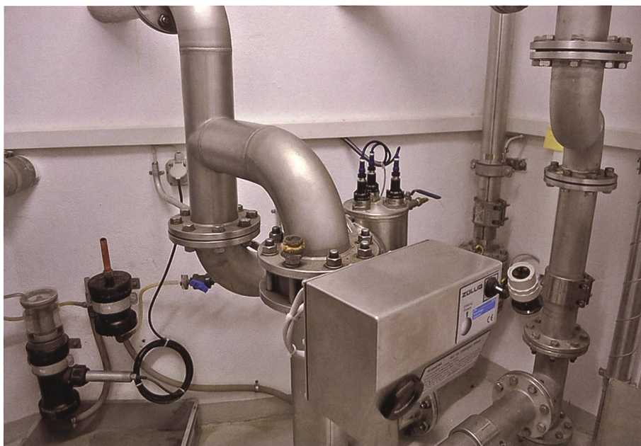
Das Reservoir und damit die gesamte Trinkwasserversorgung für die Witnauer wird heute durch die Haberbüntliquelle der Dorfkorporation Gretschins-Fontnas und durch jene der Dorfkorporation Oberschan auf Sertoteris gespeist und ist auf den neuesten Stand gebracht.
