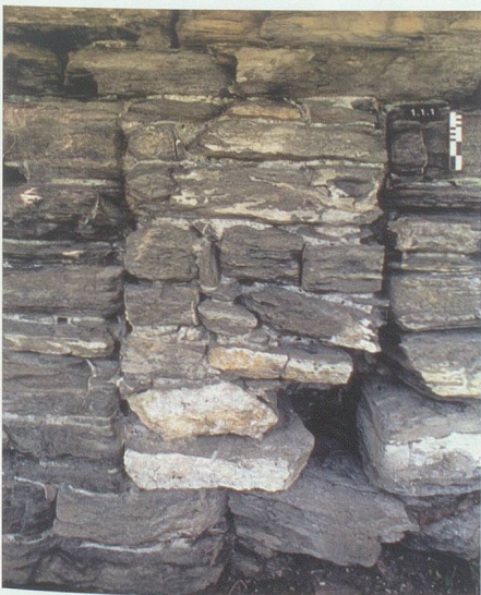
Abb. 21: Turm, Mauer M1. Zugemauerte, noch deutlich erkennbare Bau(?) - Öffnung am Mauerfuss, von ENE.
