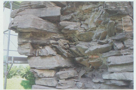
Abb. 16: Turm, Mauer M1. Locker verfüllter Mauerkerne in der Abrisskante, von NW.
