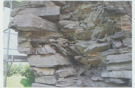
Abb. 16: Turm, Mauer M1. Locker verfüllter Mauerkerne in der Abrisskante, von NW.
