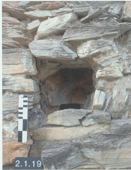
Abb. 40: Turm, Mauer M2. Im Zuge der Reparatur der Zugangslaube eingesetzter, stirnseitig angekohlter eichener Balkenrest im Balkenloch 2.1.19, von SSE.
