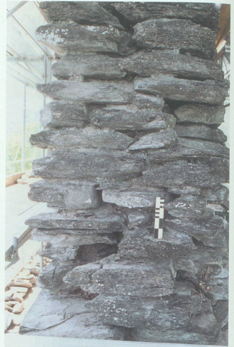
Abb. 5: Turm, Eckverband M1/M2. Stark ausgewaschenes Mauerwerk der Aufstockung oberhalb des Balkenlochs 2.7, von ENE.
