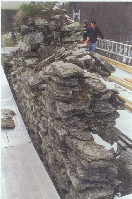
Abb. 17: Turm, Mauer M2. Stark aufgelöste Mauerkrone, von E.
