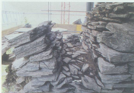
Abb. 29: Turm, Mauer M1. Teilweise eingestürzte Fensteröffnung 1.4, von WSW.
