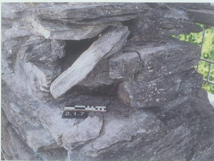
Abb. 44: Turm, Ecke M1/M2. Das Balkenloch des über Eck ausragenden Balkens 2.1.7. Es gehört zur Laube, die bei der Reparatur des Turms eingebaut wurde, von SE. Der schräg liegende Stein bildete ehemals den äusseren, oberen Abschluss des Balkenlochs.
