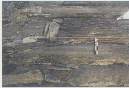
Abb. 15: Turm, Mauer M3. Mit Tuffsteinbrocken ausgeflickte Schadstellen in der Fassade (Kote Schnur 761.80), von WSW.
