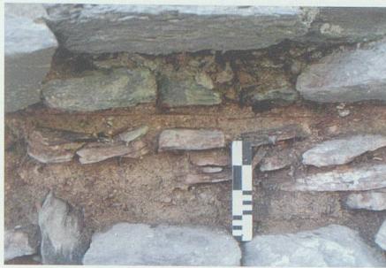
Abb. 35: Turm, Mauer M2. Horizontale Fuge im Kernmauerwerk des zweiten Obergeschosses, von NNW. Sie trennt zwei deutliche Bauabschnitte.
