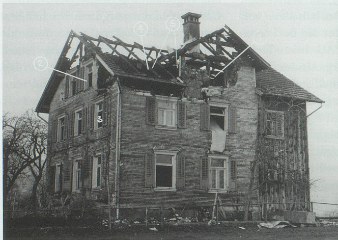
4. November 1952. Die Ost- und Südfassade des brandgeschädigten Hauses Gantenbein/Stricker in Grabs-Riet. Bild im Staatsarchiv St.Gallen (Brandakten Grabs 1/1932–1975)
