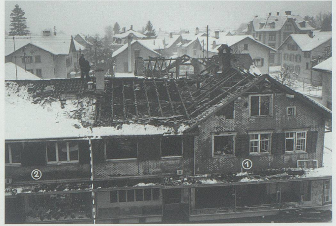
9. Februar 1963. Die stark beschädigte Liegenschaft Häusermann an der Bahnhofstrasse in Buchs. Bild im Staatsarchiv St.Gallen (Brandakten Buchs 1/1931–1974)
