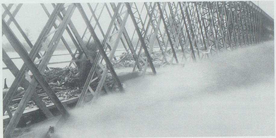
25. September 1927: Die zu tief liegende Eisenbahnbrücke behinderte den Durchfluss des Hochwassers. Der Damm wurde überflutet, was innert Kürze zum Dambruch führte. Bild aus Rheinnot 1977.
