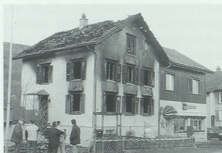
27. Dezember: Das vom Feuer stark beschädigte Gebäude an der Staatsstrasse in Sevelen.
