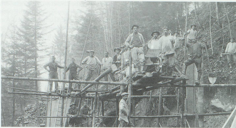
Abb. 23. Hinter der Badweid, gegen die Tobelsäge hinab: Ansicht vom Bau eines schwierigen Teilstücks der Güterstrasse Lehn-Tobelsäge, die nach 1926 erstellt wurde. Auf dem Gerüst vorn in der Mitte stehend «s Fritze Heiri», Stütli (1900 bis 1980). Bild bei Heinrich Lippuner-Eggenberger, Wachsbleichstrasse, Rorschach.
