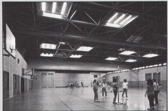
Dachkonstruktion der Sporthalle in Osnabrück-Eversberg. Das Raumfachwerk hat ein Rastermaß von 3,00 m.
