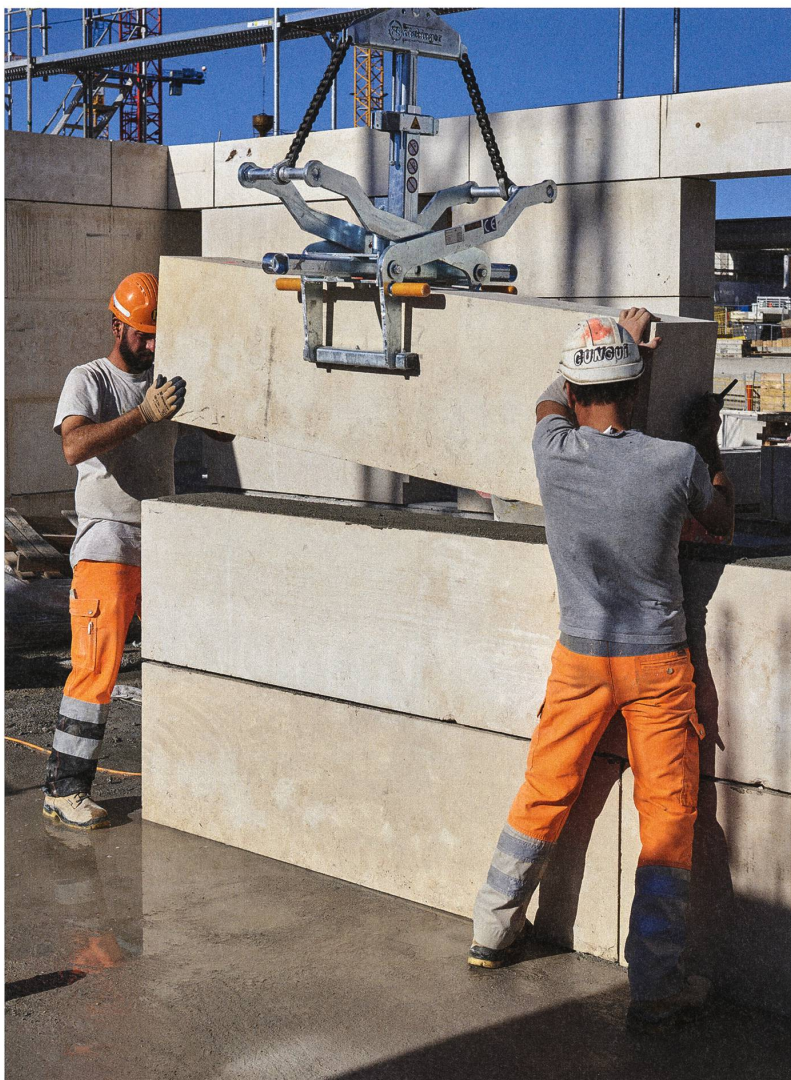
Treten Naturstein, Lehm und leimfreies Vollholz aus der ökologischen oder regionalistischen Nische heraus in eine breitere Anwendung? Mächtige Kalksteinblöcke werden auf der Baustelle einer Siedlung mit Sozialwohnungen in Plan-les-Ouates präzise gesetzt. Bild: Leo Fabrizio
