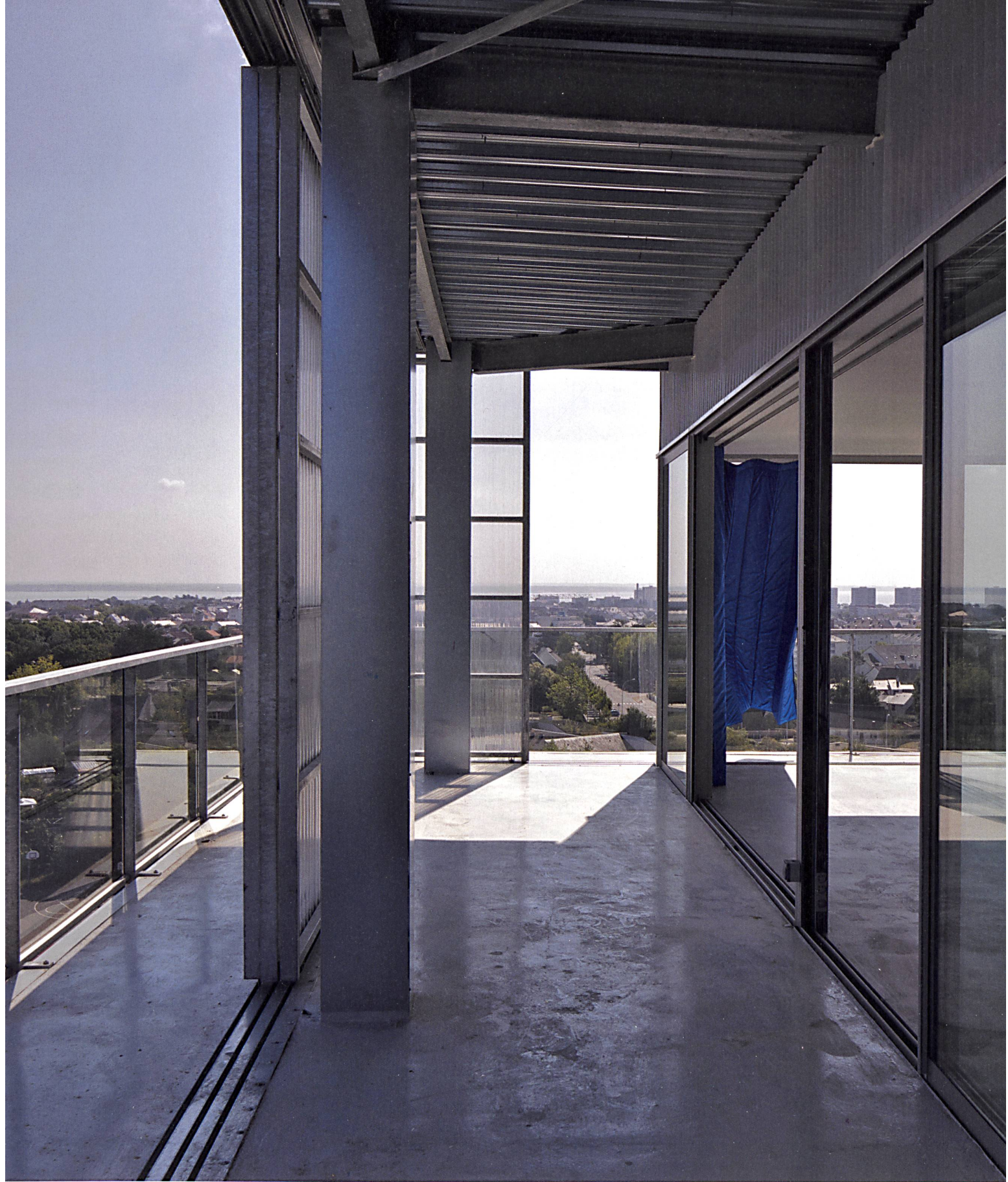
Der freie Blick bis zum Atlantik soll nicht getrübt werden: Stahlbleche verkleiden die unansehnliche Brandschutzschicht der Stützen.
