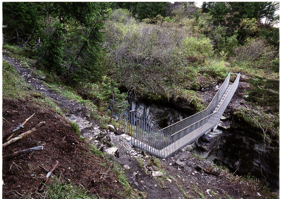
Konstruktion und Gestalt der sieben Brücken interpretieren die vorgefundene Landschaft und verstärken das Erlebnis der Schluchten.
