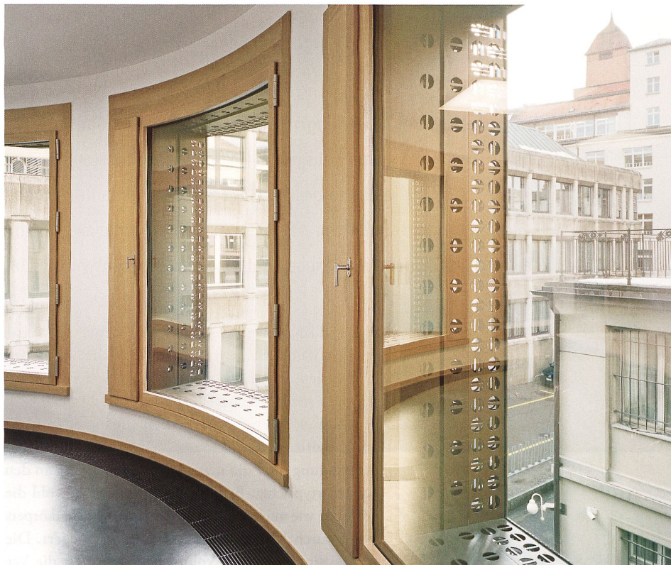
Tiefe, in Baubronze gefasste Fensterleibungen nehmen Bezug auf die feineren Profile der historischen Fenster.
