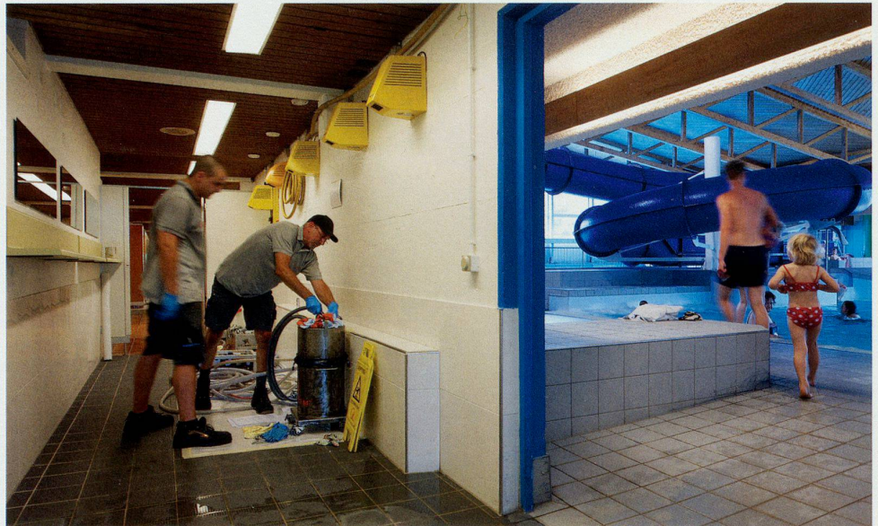
Rohrrinnensanierung mit HAT-System: Keine Baustelle. Kein Aufreissen. Kein Bauschutt. Kein Lärm. Also auch keine Betriebsunterbrechungen.
