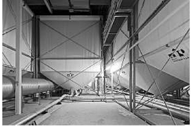
Materialsilos im Obergeschoss
