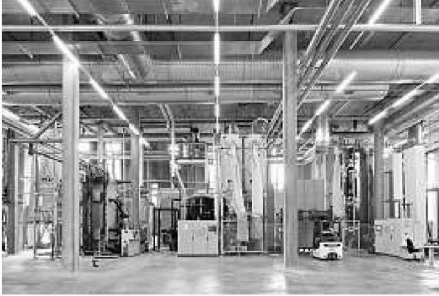
Produktionsanlagen im Erdgeschoss unter Silos
