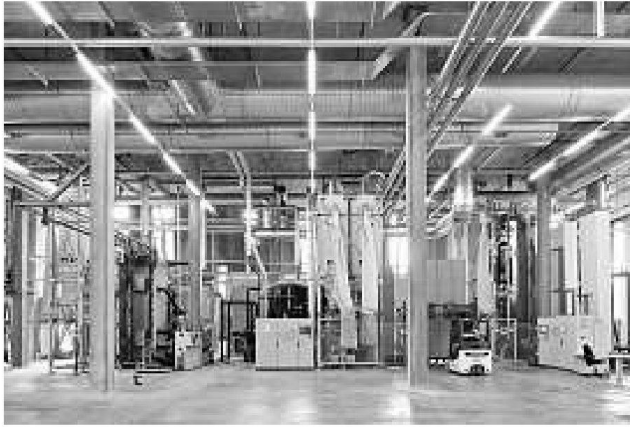
Produktionsanlagen im Erdgeschoss unter Silos
