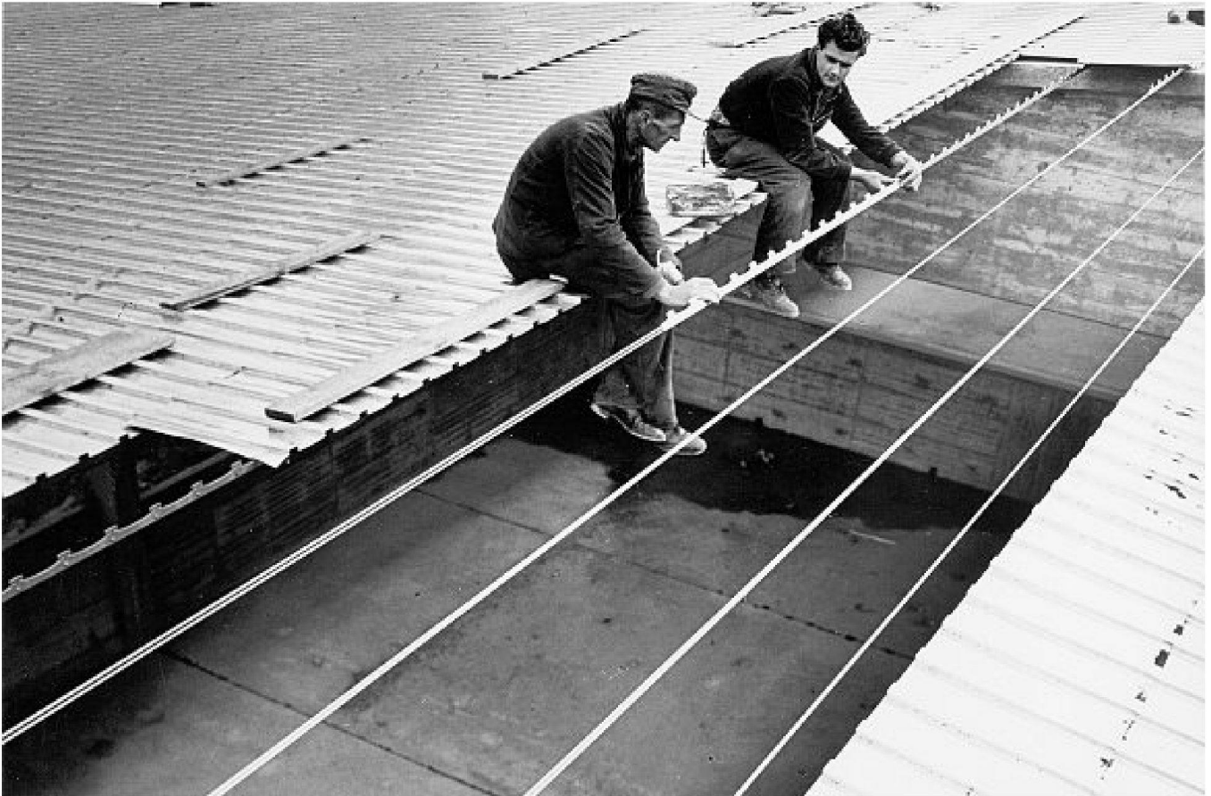
Fural auf Spannstahlträgern. Die Furalhalter sind an doppelt geführte Drähte geklemmt, womit Spannweiten von bis zu 15 m überbrückt werden können. Die Abbildung zeigt vermutlich die Fasslagerhalle der ÖBB in Inzersdorf (A), wo das Dach noch heute existiert. – Bild: Staatsarchiv Uri, Altdorf; PA «Nachlass Josef Furrer-Gisler (1910–1976) / FURAL»
